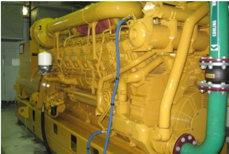
Interno della Hybrid Power Station
